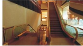
Typical Escalator 自动扶梯
